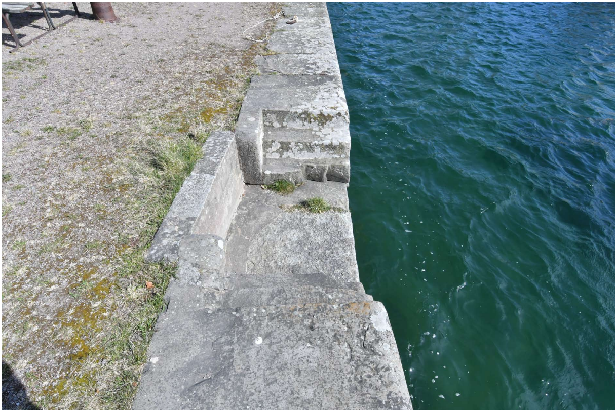
Kajen har nedskurna trappor på vissa ställen för enklare i- och urstigning i mindre båtar. Generellt är kajbyggnaderna i natursten och med äldre järndetaljer en viktig och autentisk del i kulturmiljön.
